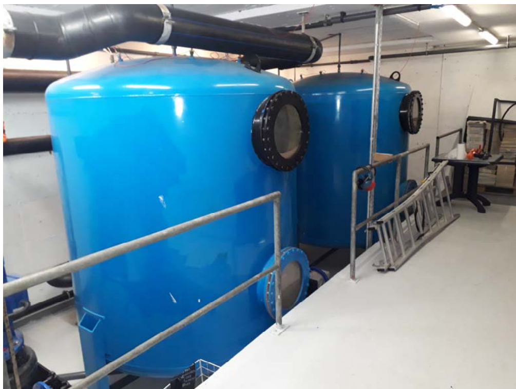
Filtres à sable de la piscine du Centre Sportif de Versoix
