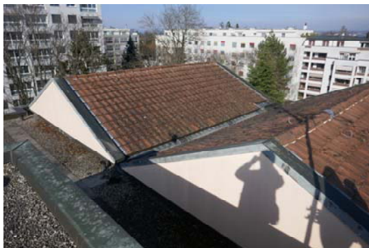
Les toitures à deux pans sur charpente bois avec couverture en tuiles
