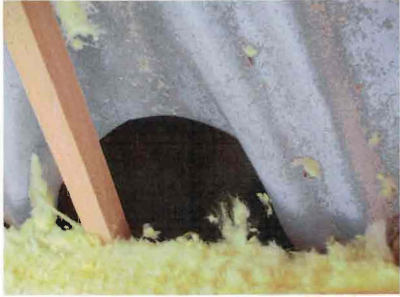
Barrière vapeur non étanche
